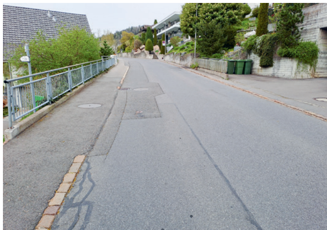
Belagsflicke mit fehlendem Trottoirrandstein
