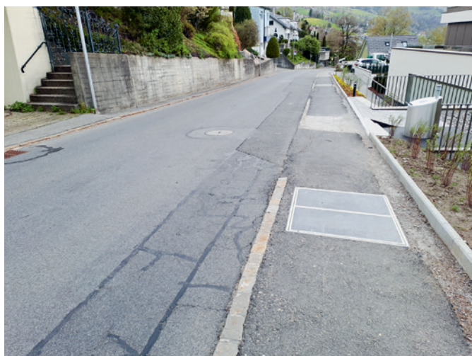
Risse und Belagsflicke
